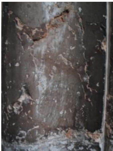
Foto 55. Dettaglio del degrado, 2012
