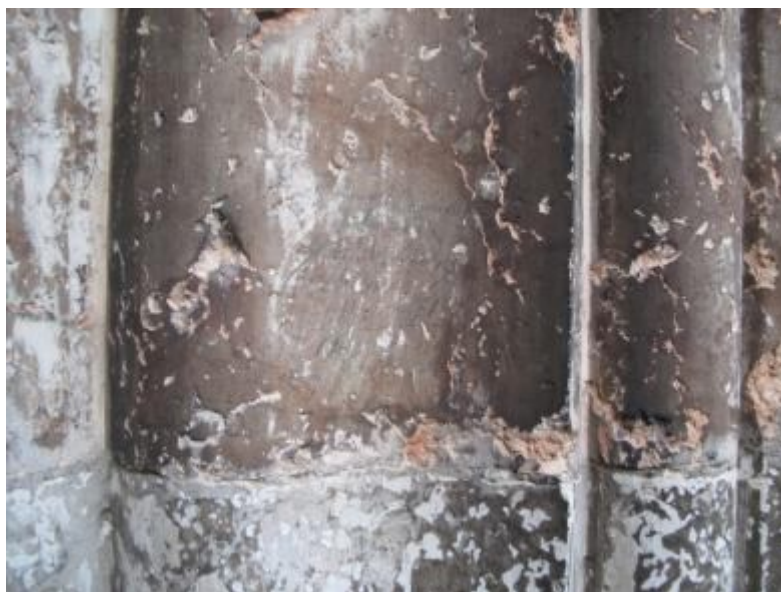
Foto 58. Particolare del degrado, 2012
